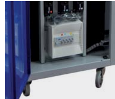
Disjuntor de proteção Cortacircuitos
