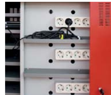
Armazenamento de transformadores Almacenamiento adaptadores AC
